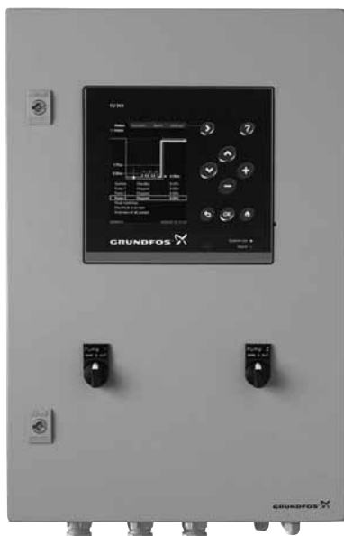
Rys. 17 Szafka sterownicza DC
