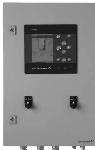
Rys. 50 Szafka sterownicza Sterowników Dedykowanych
